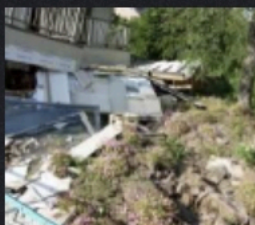
＜著しい地盤変状＞
