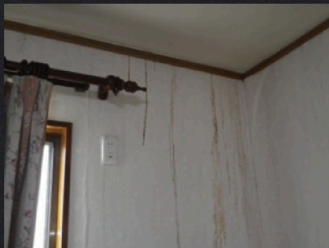
室内に雨漏り染み
