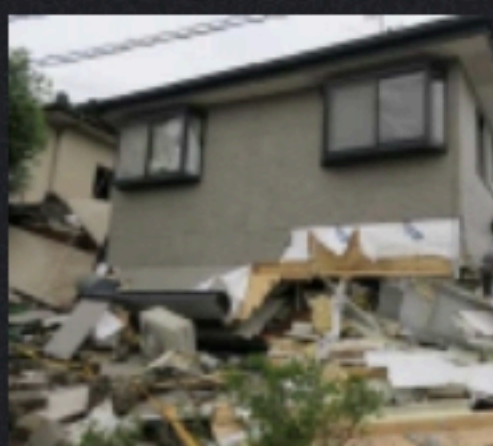
＜隣棟建物の衝突＞
