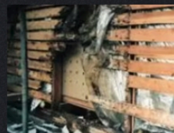
結露の水分によって腐朽菌が発生し、柱や土台を腐らせ、建物の寿命を縮めます。
